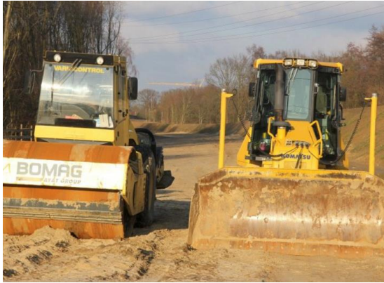
Bagger und Raupen sind auf der 2,9 Kilometer langen Trasse im Einsatz Foto: Andreas Daebeler / HA
