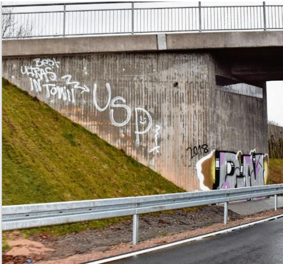
DIE BAUWERKE SIND BEREITS MIT GRAFFITI BESCHMIERT.
